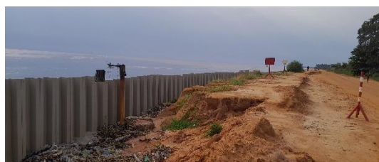
Érosion côtière entre Banana et Muanda
